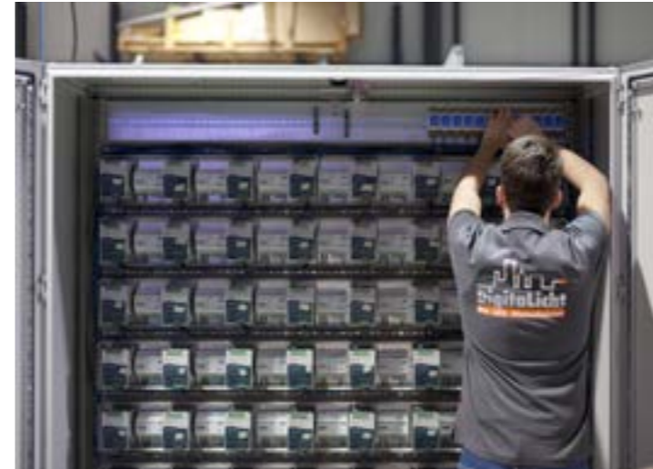
Schaltschrankbau / Switch-Panel Assembly
